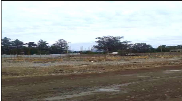
Primera etapa: Terreno ya limpio y listo para dar inicio a las obras.
